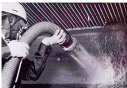
＜石綿吹き付け＞
